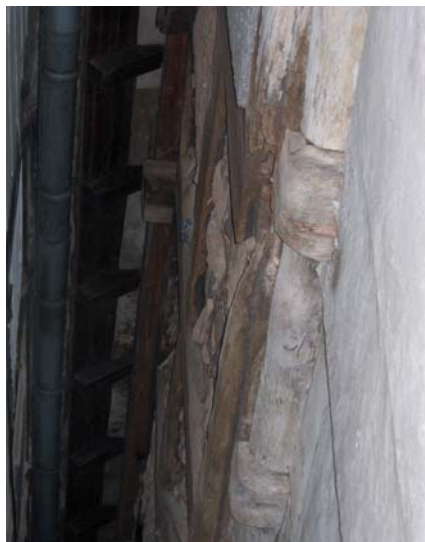
Blick von An der Mauer diagonal nach oben auf die westliche Außenwand mit verfallener Saumschwelle
